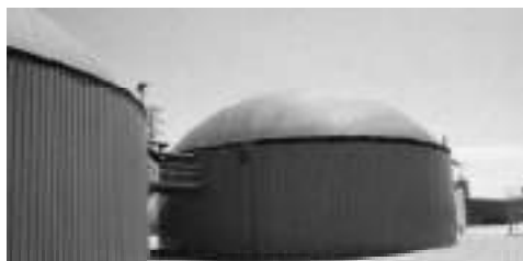
Figura 7.1. Gasòmetre flexible amb coberta de digestors anaerobis (Vilasana, 2007)
