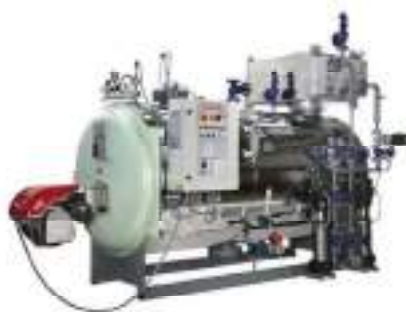
Figura 9.6. Caldera de biogàs.
